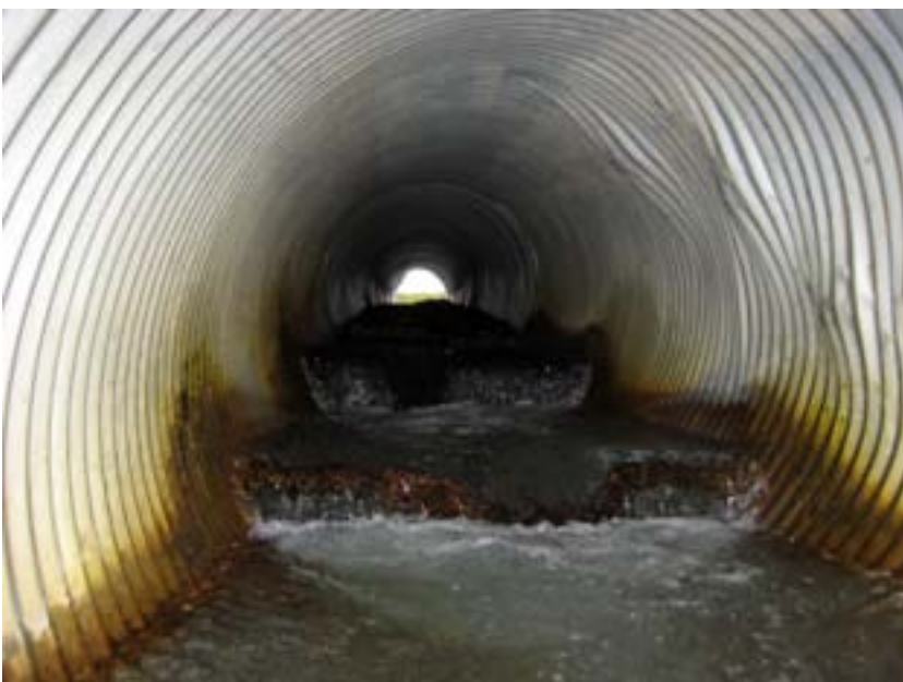
Mynd 27.2. Fiskvegur í ræsi í Stafá í Helgafellssveit. Steyptir þvergarðar sjást inni í ræsinu til að auðvelda fiskför um ræsið. Ljósmynd, Auðunn Hálfðanarson.
